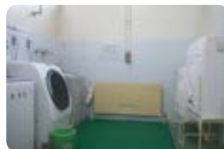
洗濯機・乾燥機
